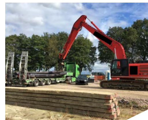
Foto van de plaats van het ongeval
