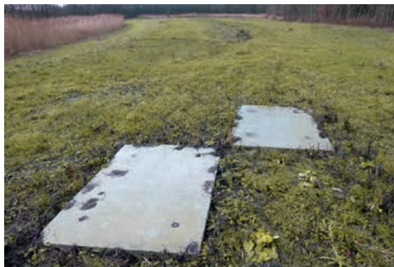
Cross-Bonding-Kästen in der Betriebsphase
